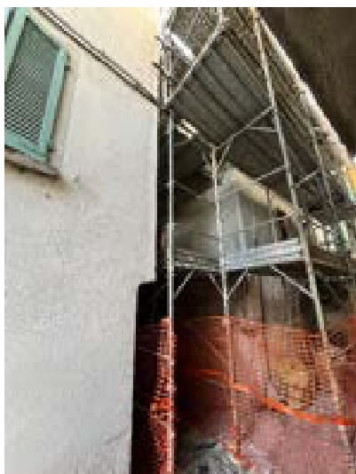
Nuova installazione N000007
